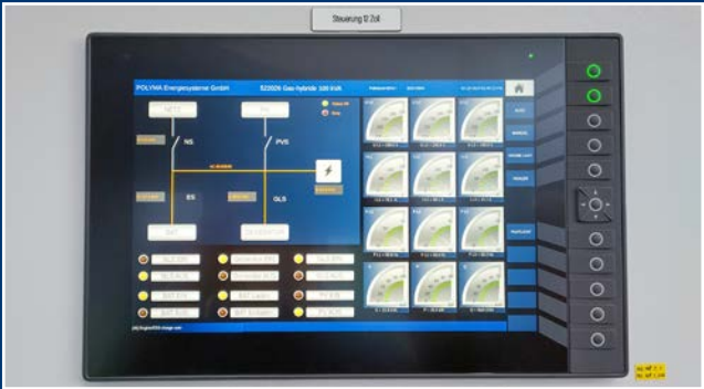
12" Touchdisplay übersichtlich gestaltet mit Maschine, Batterie, Netzanschluss und PV-Anlage.
