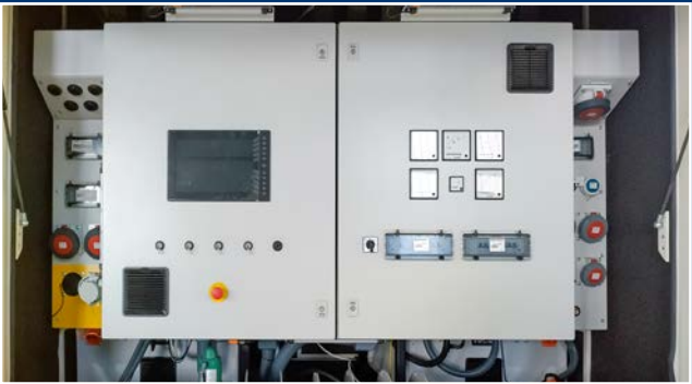
Übersichtliche Schaltanlage mit Abgangs- und Zugangsfeld.
