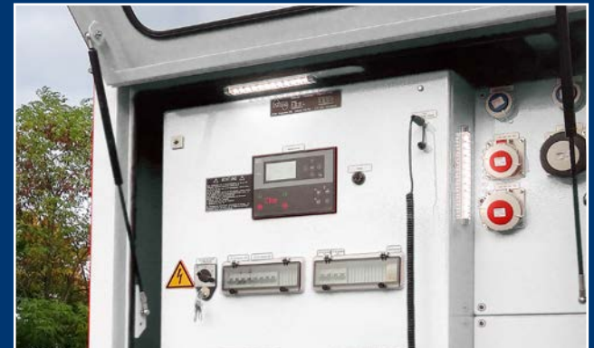
Übersichtliche Schaltanlage schalltechnisch abgeschirmt und im Verkehrsschatten angeordnet.
