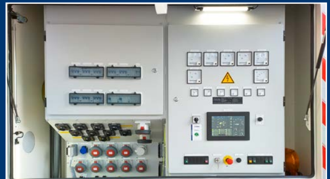
Individuelle Schaltanlage mit 10" Touchdisplay, analogen und digitalen Anzeigen. Automatische Beleuchtung und Bodendurchführung für Anschlussleitungen.
