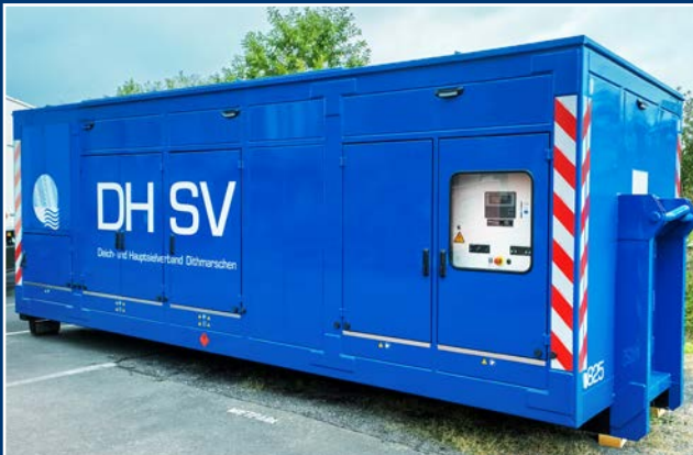
650 kVA Abrollcontainer mit integrierter Kabeltrommelanlage, Notstromautomatik und Parallelbetrieb.
